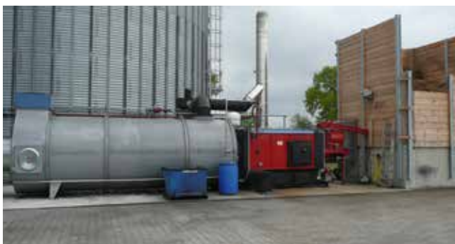
Indirekter STELA-Luftherhitzer mit Bioflammeuerungsanlage
