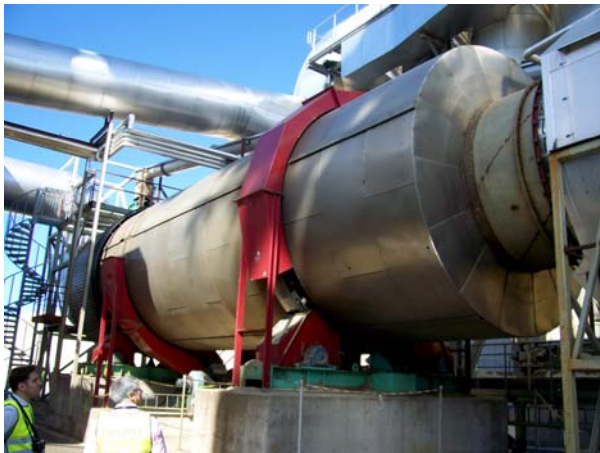
Fig. 2 Trommeltrockner in einem Pelletierwerk
