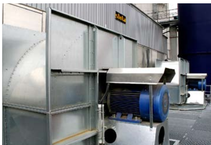
Die zwei Ventilatoren mit langsamem Lauf sparen Energie bei einem gleichbleibenden Volumenstrom
