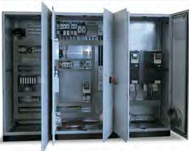
Kontrollsystem mit SPS control with PLC
